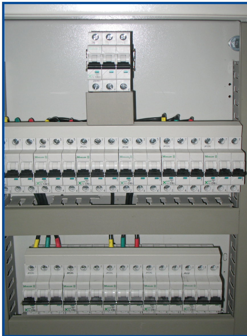
Щит розподільчий (ЩР)
